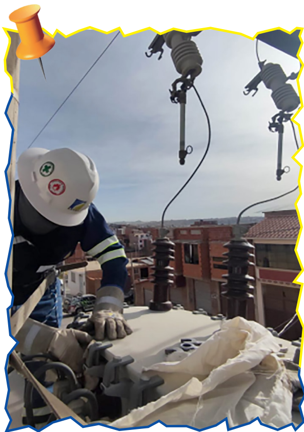
Mantenimiento transformador T1231, Alto Munaypata
