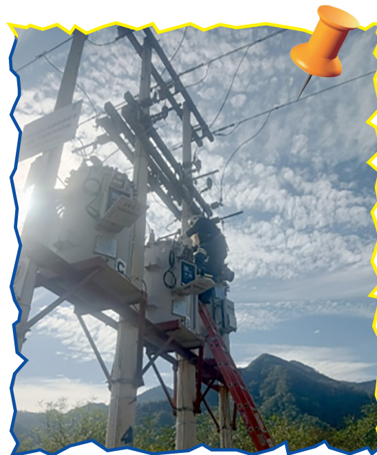
Pruebas eléctricas a reguladores de tensión Pedernal.
